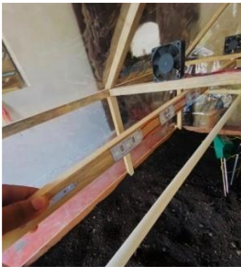
Luces ya instaladas en el techo de nuestro prototipo.
